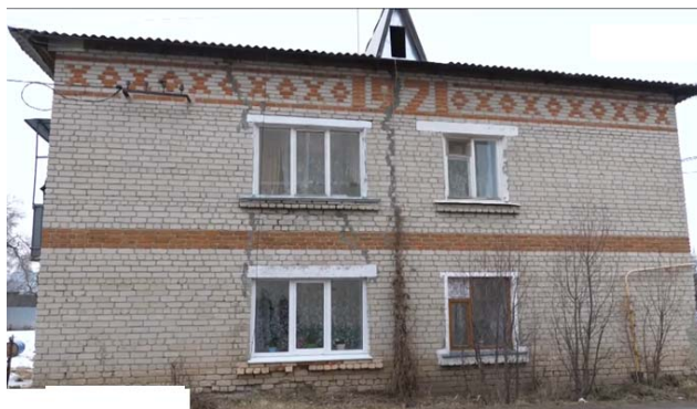
Рис. 7. Разрушение каменной кладки стен в их цокольной части, г. Ядрин, ул. 50 лет Октября, 98
