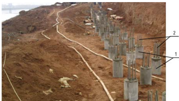
Рис. 10. Схема устройства усиления оползневого склона: 1 – буроинъекционные сваи ЭРТ в три ряда; 2 – выпуски арматурного каркаса свай
