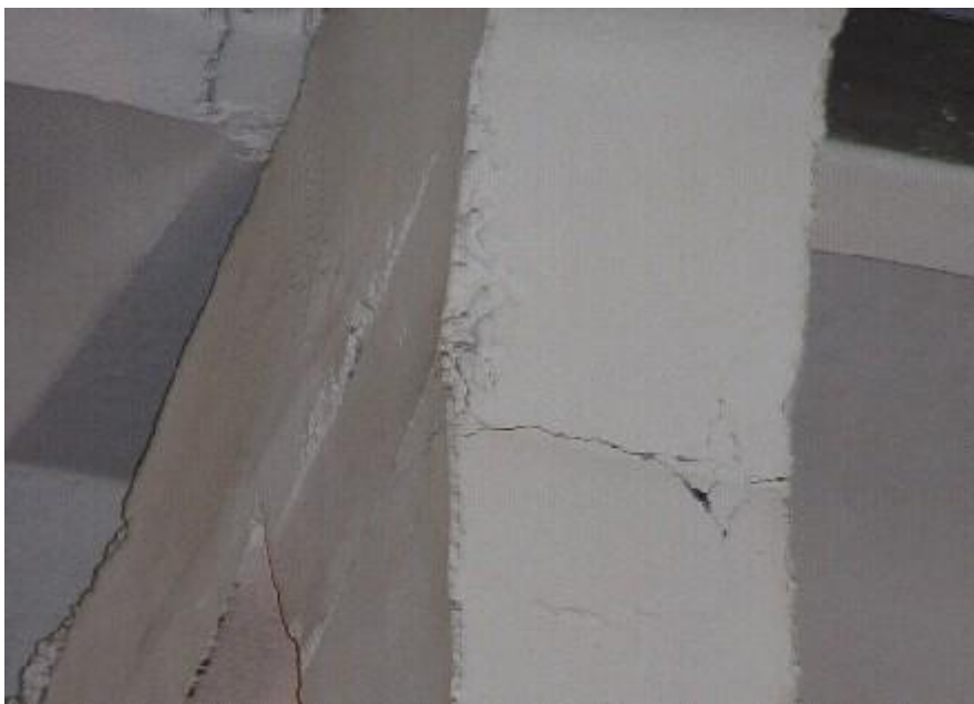
Фото 1. Нормальные трещины в вутах верхнего пояса фермы
