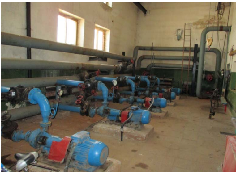
Рисунок 1 – Машинный зал ЦТП №1 до реконструкции насосного оборудования
