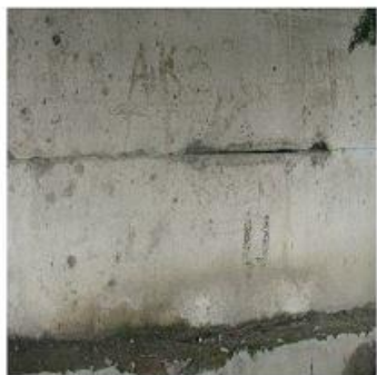
Рис.4. Раскрытие стыка стеновых панелей
