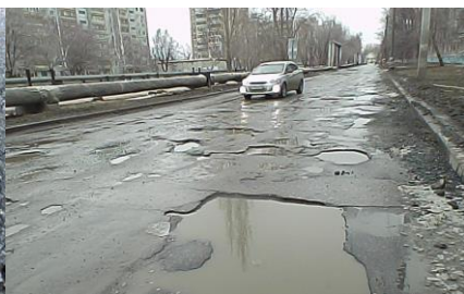
Рис. 2. Весеннее разрушение дорожного покрытия
