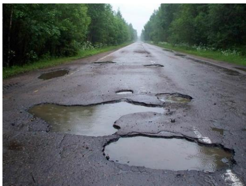
Рис. 3. Выбоины на покрытии в конце весеннего периода, к которым не применяли купирование инертным материалом
