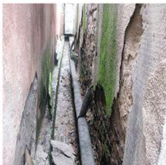
Рис.3. Увлажнение и крошение кирпичной кладки стены на глубину до 5см.
