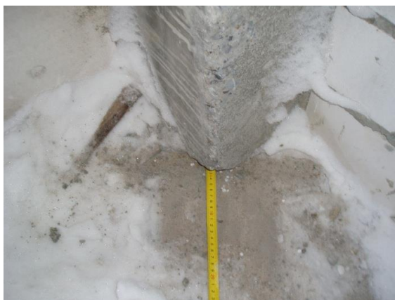
Рис. 2. Зазор в углу стыка глубиной до 30 мм в узле 1-Б на уровне 1-го этажа (отм. \pm 0,000 ).
