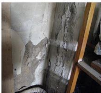
Рис.5. Отслоение и крошение штукатурных слоев
