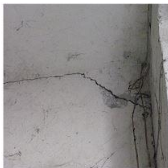
Рис.6. Раскрытие стыка стеновой панели с плитой перекрытий
