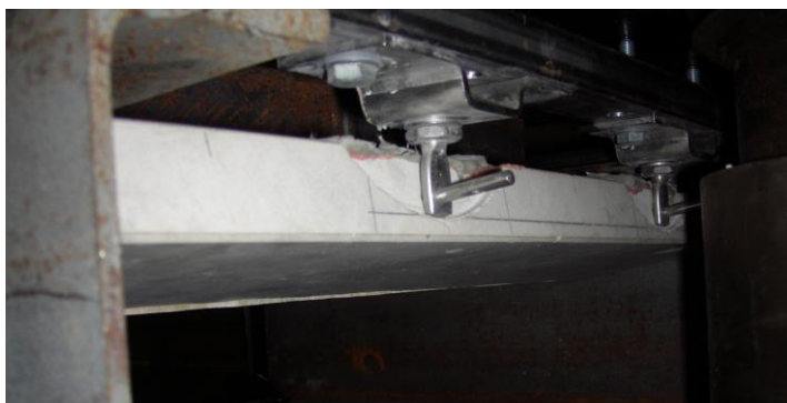
Рис. 10. То же, что и рис.9, вид снизу. Вид усиленной плиты после разрушения по схеме нагружения 1. Общий прогиб плиты составляет 20мм. Смещение краев фрагментов плиты – 1-3мм.
