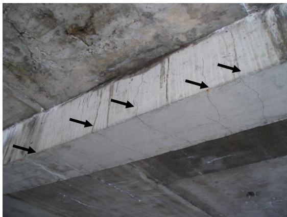
Рис. 1. Трещины в сборной части ригеля в перекрытии 7-го этажа
