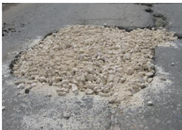
Рис. 6. Выбоина, заполненная малопрочным известняковым щебнем
