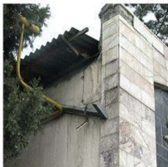
Рис.2. Отсутствие асбест-ных листов кровли.
