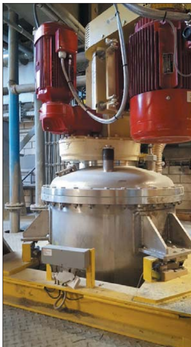
Рис. 1. Суспензионный смеситель на газобетонном заводе
